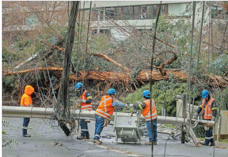
Árboles y ramas caídas son, por lejos, la principal causa del corte del suministro eléctrico. De ahí que la mantención preventiva con tecnología de punta surja como una solución prioritaria.
