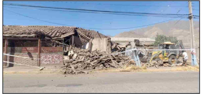
Este martes 4 de marzo comenzó la demolición de la casa abandonada ubicada en Avenida Maipú esquina Manuel de Lima.
