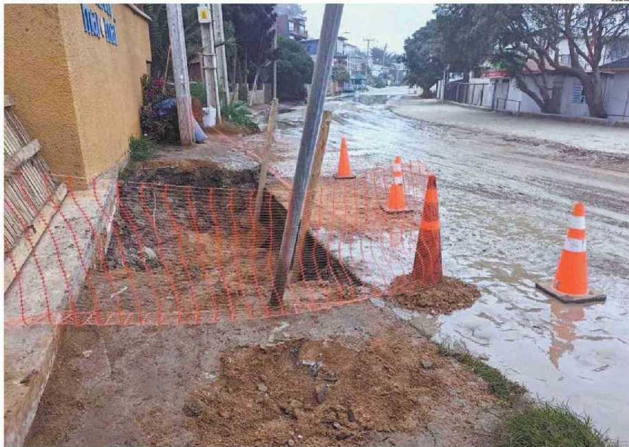
VECINOS DENUNCIAN POSIBLE FILTRACIÓN DE AGUAS SERVIDAS CON RIESGO SANITARIO EN LA AVENIDA PRINCIPAL DE LOS MOLLES.
