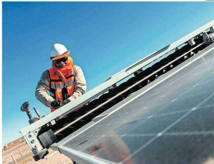
EL PARQUE FOTOVOLTAICO INSTALADOS TIENE UNA CAPACIDAD INSTALADA DE 480 MW.
