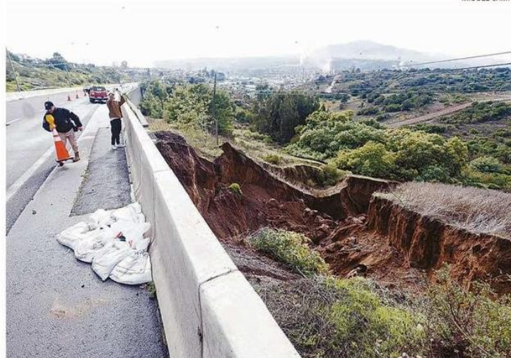
REPARACIÓN DE CÁRCAVA EN RUTA F30E PODRÍA DILATARSE HASTA INICIOS DEL AÑO 2025.
