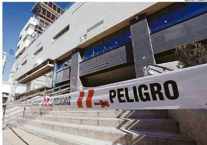
EL ACCESO PRINCIPAL DEL HOSPITAL ESTÁ CERRADO TRAS LA CAÍDA DE UNA PALMETA DEL FRONTIS.
