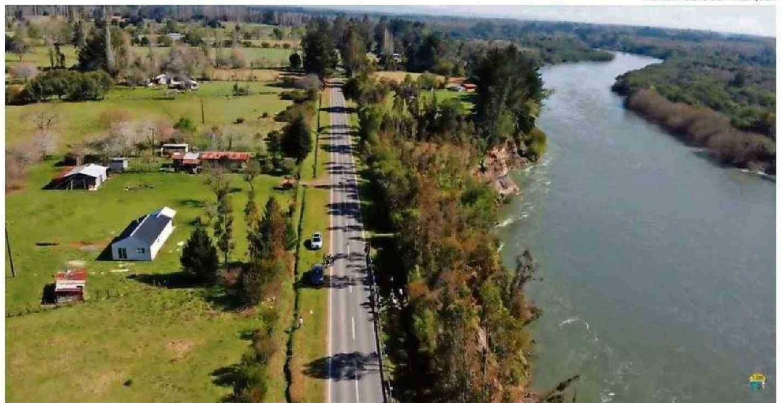
EL RÍO TOLTÉN SE HA IDO “CARCOMIENDO” LA TIERRA Y ESTÁ GENERANDO UN PELIGROSO BARRANCO A MENOS DE DOS METROS DEL CAMINO.
