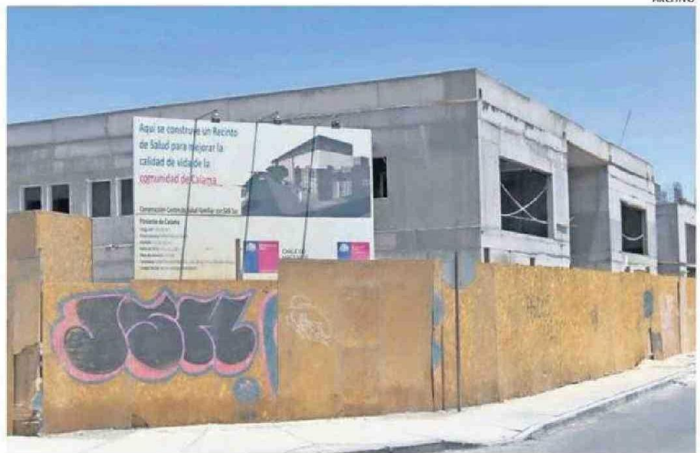
COMDES ESPERA QUE SE RETOMEN LAS OBRAS DEL CESFAM SURPONIENTE DE CALAMA.
