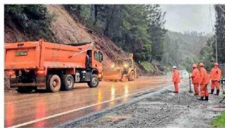
Trabajo en conjunto con la Dirección de Vialidad para habilitar la ruta CH-156 de La Madera.
