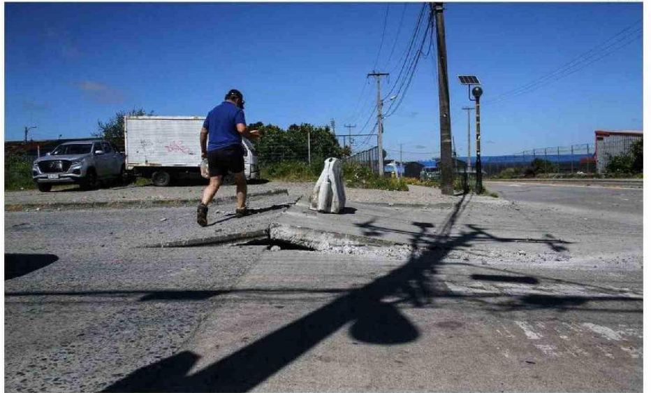
ASÍ QUEDÓ EL PAVIMENTO EL VIERNES EN LA TARDE. UN CAMIÓN TUVO PROBLEMAS PARA SEGUIR SU MARCHA DURANTE ESA NOCHE.
