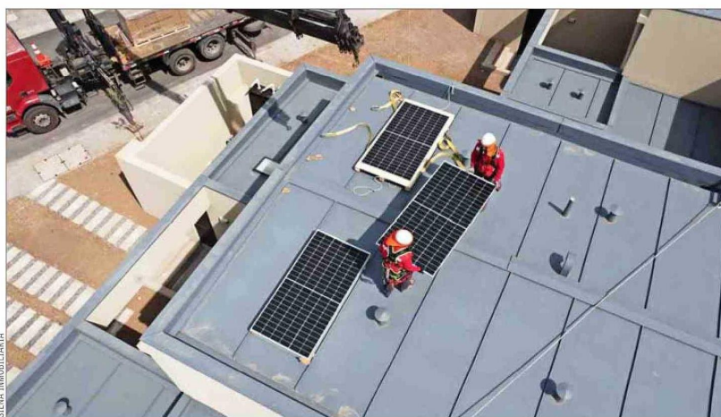
Las casas del Condominio Canquén Norte tienen instalados los paneles en la cubierta del techo.
