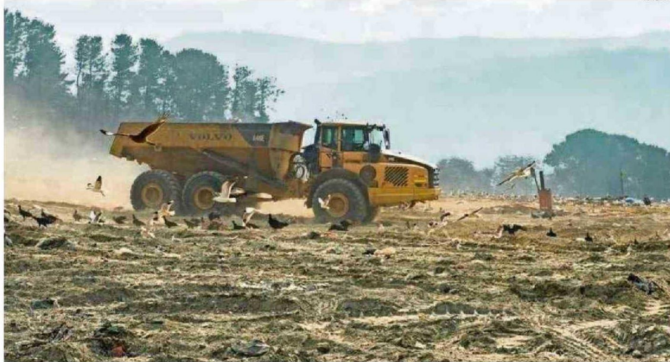
LA EXTENSIÓN DEL ÁREA ORIGINAL DE OPERACIÓN Y DISPOSICIÓN DE RESIDUOS NO CUENTA CON AUTORIZACIÓN SANITARIA DE FUNCIONAMIENTO.
