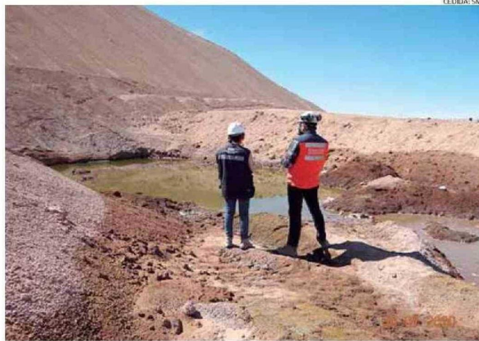
LAS FILTRACIONES AFECTAN A LA INFRAESTRUCTURA VIAL Y FERROVIARIA.
