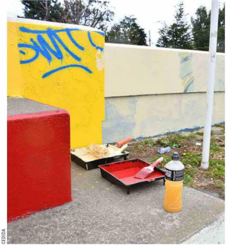
El mejoramiento de plazas es constante, debido principalmente al actuar vandálico de desconocidos.
