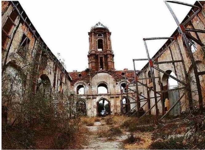
EL SINIESTRO DEL AÑO 2013 PROVOCÓ DAÑO PRÁCTICAMENTE TOTAL EN LA IGLESIA Y EN EL CONVENTO.
