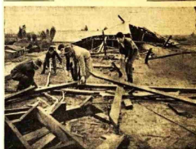
DAÑOS DEL TORNADO EN LINARES
