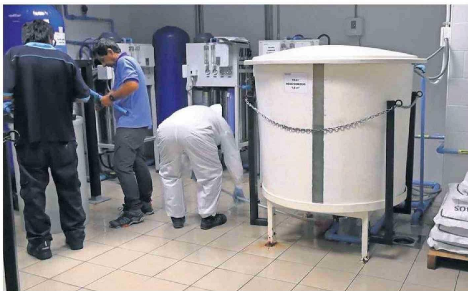
ESTE ES EL TERCER EPISODIO DE FILTRACIÓN DE AGUA EN EL HOSPITAL REGIONAL
