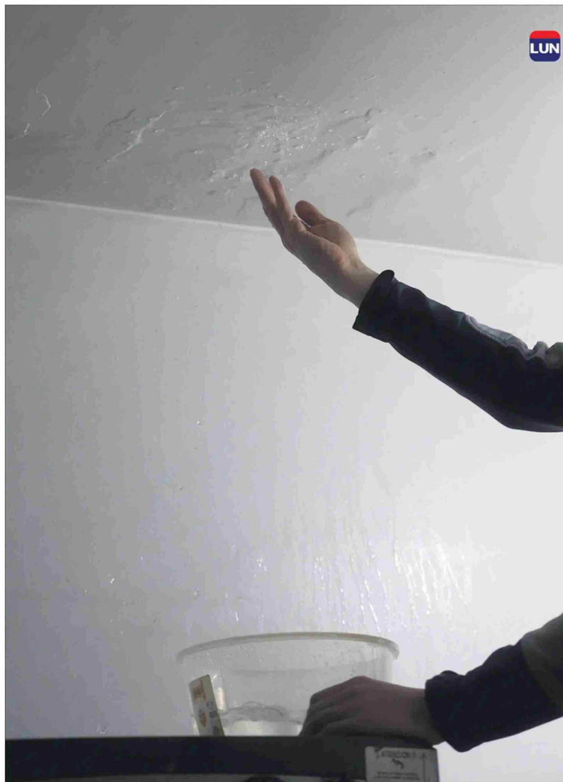
"Si el techo tiene manchas puede ser por humedad", dice constructor.
