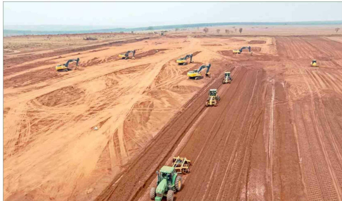
La firma chilena comenzó los movimientos de tierra en Brasil para la construcción del Proyecto Sucuriú, que tendrá una planta con capacidad de producción anual de 3,5 millones de toneladas de celulosa.
