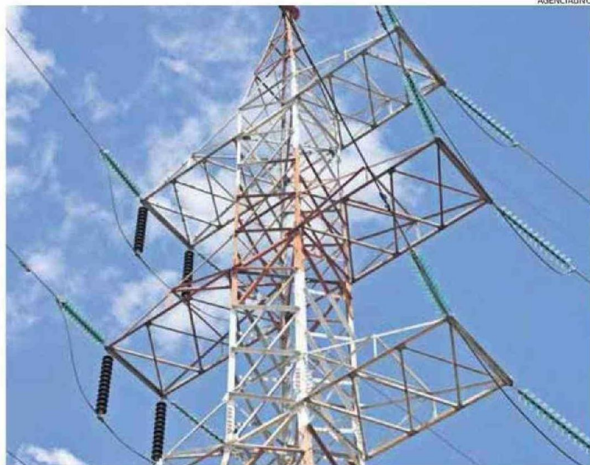
EL TRAZADO DE LA MEGALÍNEA DE TRANSMISIÓN ES DE 1.346 KILÓMETROS, CONSIDERANDO 2.691 TORRES.
