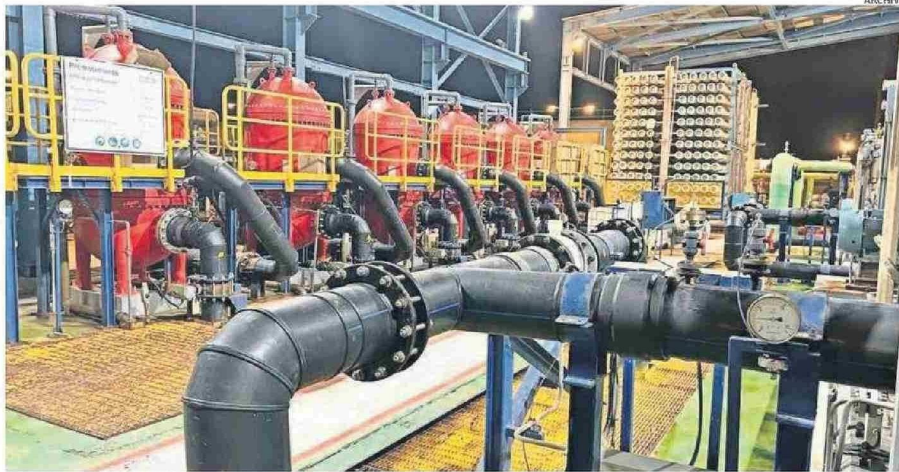
LA DESALADORA DE ADASA PRODUCE CASI 1.000 L/S. LA PLANTA DE ESCONDIDA(BHP) PODRÍA APOYAR CON UN SUMINISTRO ALTERNATIVO A LA CIUDAD.
