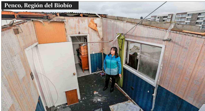
Penco, Región del Biobío VIENTOS. — Pese a que se pensó que era una tromba marina, el fenómeno que generó daños en Penco se trató de un tornado menor.
