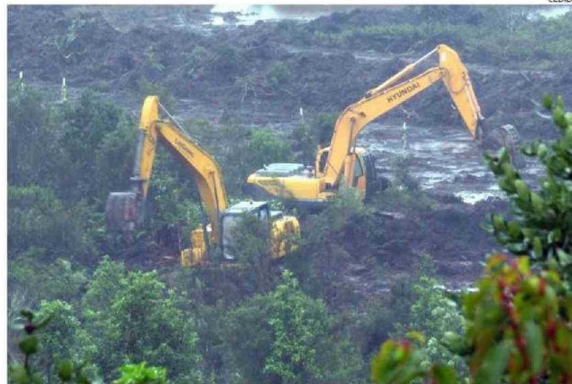
ESTA IMAGEN FUE CAPTADA POR LOS VECINOS EL MIÉRCOLES 26 DE JUNIO CON MAQUINARIA EN EL HUMEDAL.
