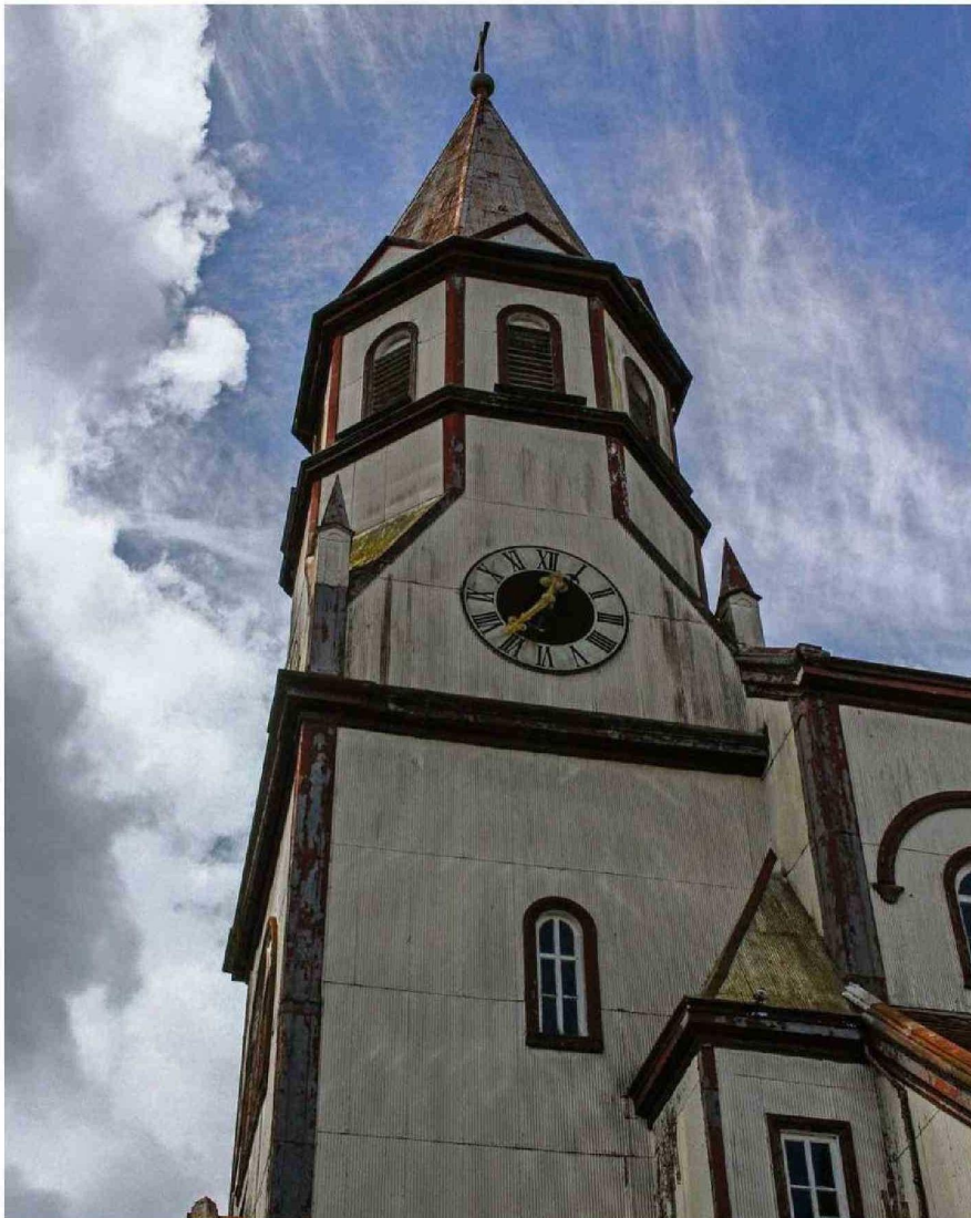
EL TEMPLO DE LA CIUDAD LACUSTRE REQUIERE DE OBRAS DE MANTENCIÓN, MIENTRAS SE DESARROLLA EL PROYECTO DE RESTAURACIÓN.
