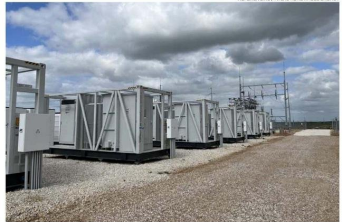
EL SISTEMA CONSIDERA 110 BLOQUES DE ALMACENAMIENTO, CADA UNO CON DOS BLOQUES DE BATERÍAS.
