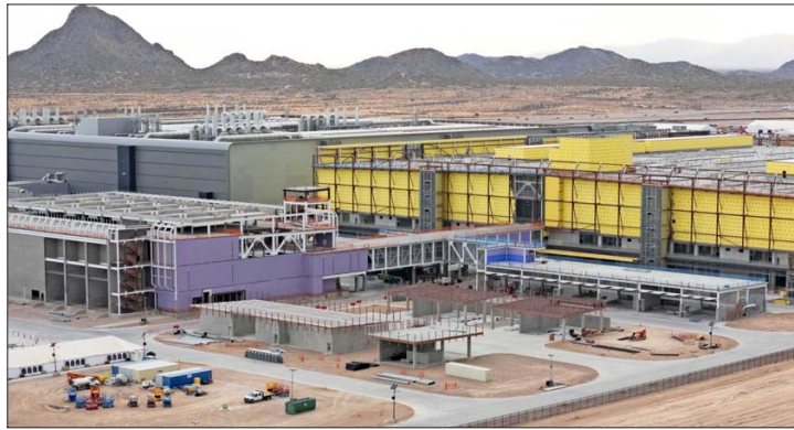
Una planta de fabricación de semiconductores de Taiwán en construcción en Phoenix en marzo.
