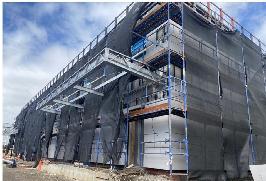
LA CONSTRUCCIÓN DEL CESFAM DE CHUYACA PRESENTA UN 80% DE AVANCE, POR LO QUE SE ESPERA ESTÉ OPERATIVO A FINES DE ESTE AÑO.
