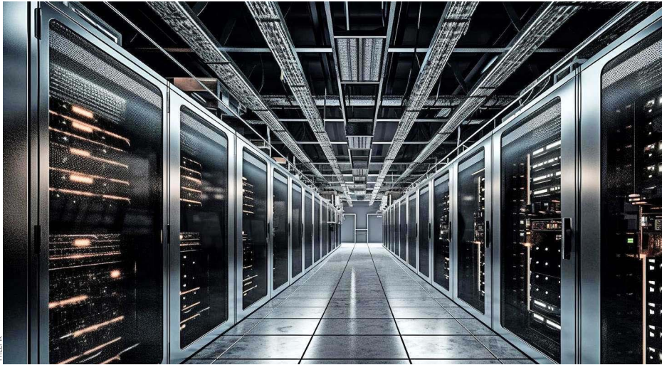
Hoy, existen 33 data centers y 228 MW de capacidad TI instalada que se concentran principalmente en la Región Metropolitana.
