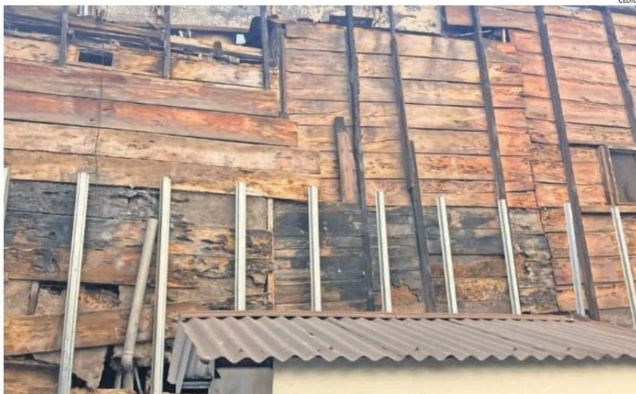
EL MURO DEL INMUEBLE COLINDANTE AL COSAM PRESENTA DAÑOS Y SE ENCUENTRA SOPORTADO POR EL EDIFICIO DEL COSAM.
