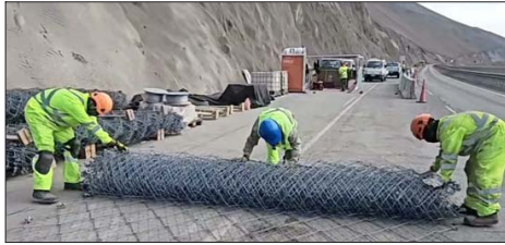
ZONA MÁS CRÍTICA. — A menos de una hora de viaje desde Arica están concentrados los trabajos en la Ruta 5. Ahí, la instalación de mallas se mezcla con el uso de maquinaria pesada y la estabilización de los terrenos.
