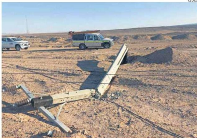
253 CLIENTES DE SIERRA GORDA SE VIERON AFECTADOS.
