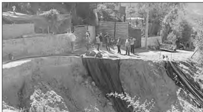
Un equipo de Senapred recorrió el socavón para tomar medidas de contingencia antes del invierno.
