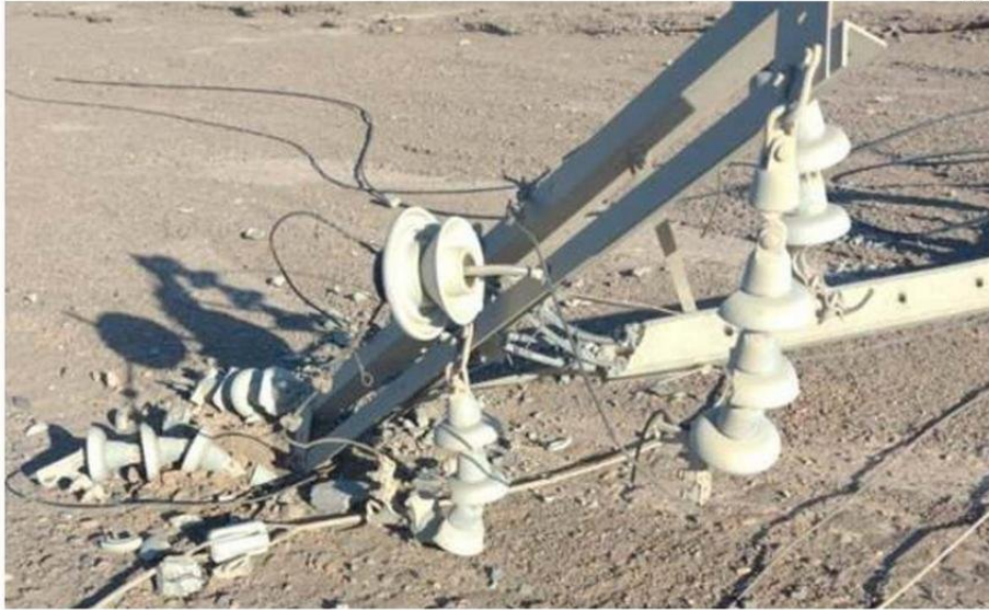
EN EL TAMARUGAL SE HA LOGRADO ESTABLECER QUE BANDAS SUSTRAEAN LAS LÍNEAS DE MEDIA TENSIÓN.
