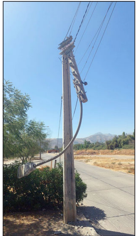
Así quedó el poste de luz el miércoles 26 de febrero, luego de ser derribado por un camión.
