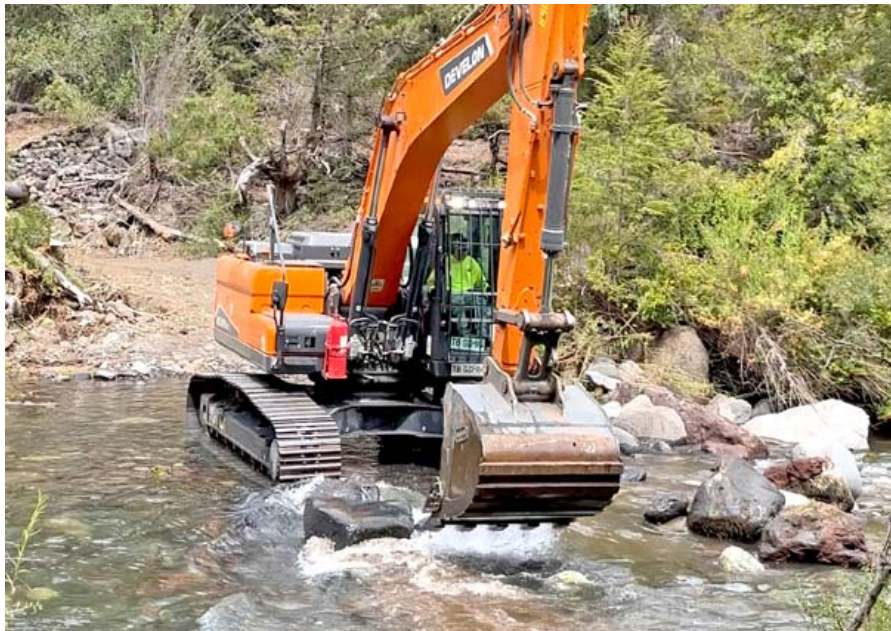
Con maquinaria pesada se logró realizar vados que permitirá atravesar el río y poder agilizar el paso vehicular.
