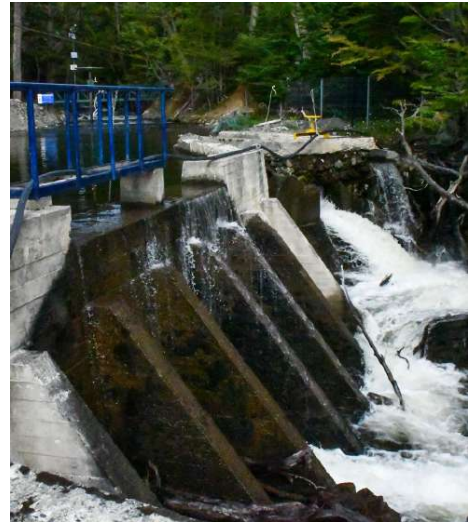
De estas instalaciones depende el suministro de agua potable de la isla Navarino.
