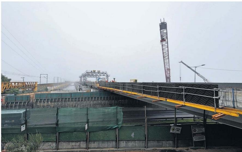
El puente Ferroviario es una de las obras de infraestructura más esperadas de la Región del Biobío.
