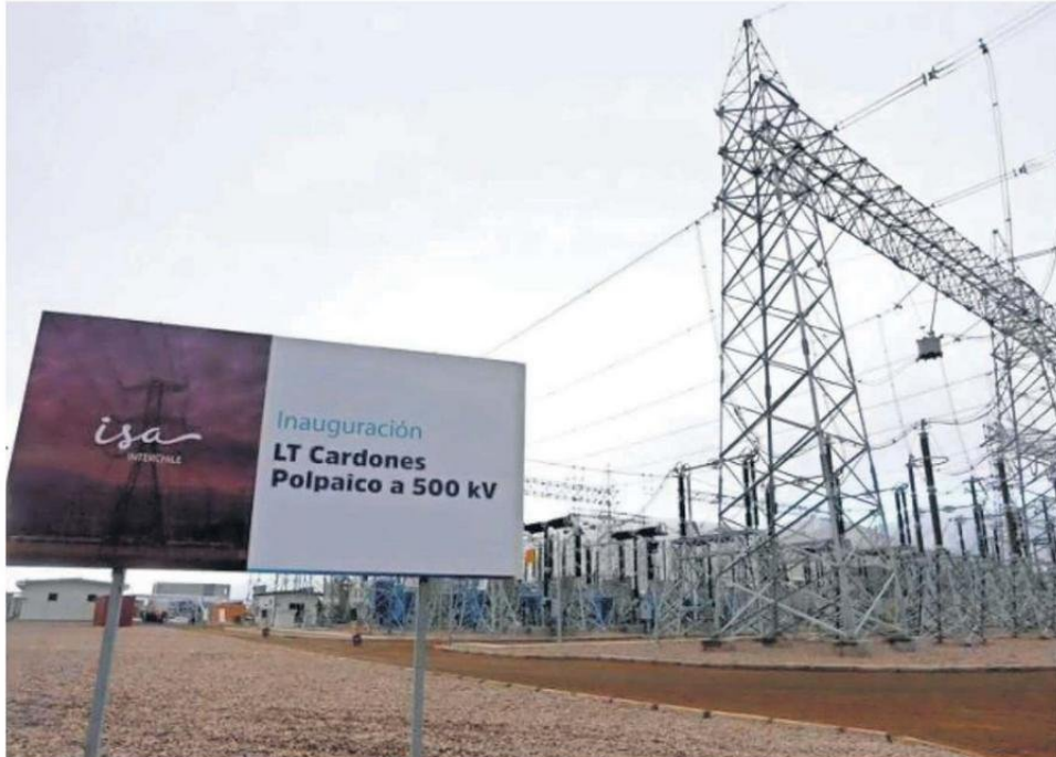
La falla ocurrió en uno de los sistemas de transmisión eléctrica del país, específicamente en la subestación Nueva Pan de Azúcar - Polpaico.
