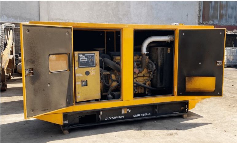
EL GENERADOR QUE APORTA la electricidad en el hospital cuando falla el servicio regular.
