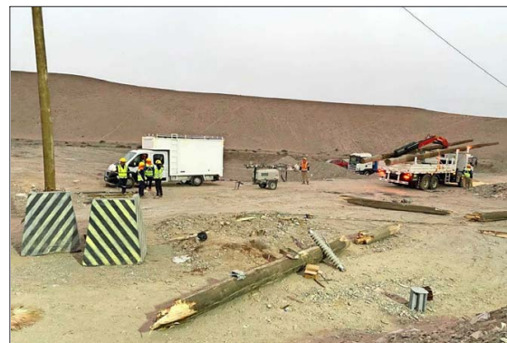
EMERGENCIA. — Cerca de 34 mil clientes en Copiapó fueron afectados por el robo de cables de la línea de transmisión. El servicio fue repuesto alrededor de las 12:05 horas de ayer.
