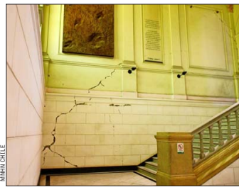
El Museo Nacional de Historia Natural todavía exhibe las grietas que le provocó el sismo de 2010. Su segundo piso está inhabilitado.
