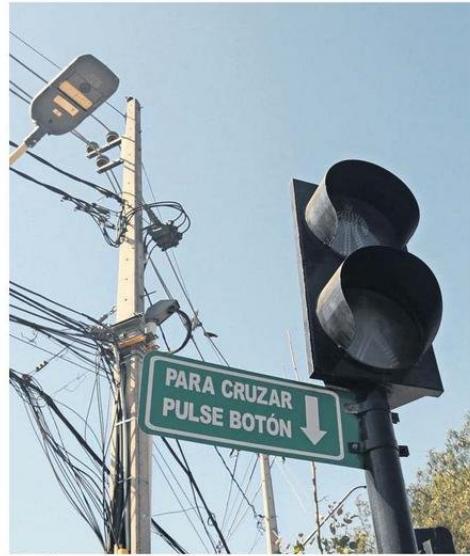
Semáforos y postes también estuvieron sin suministro.
