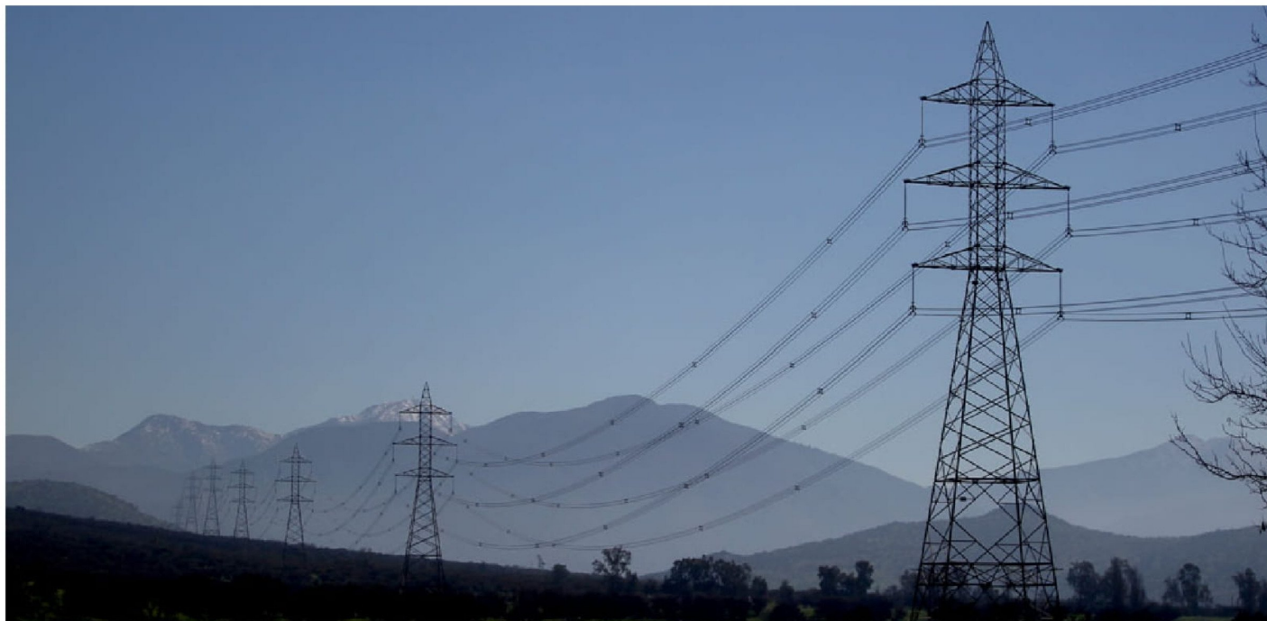
► Esta emergencia eléctrica sólo es comparable, en términos de afectación, con una ocurrida el 14 de marzo de 2010, desde Antofagasta hasta Chiloé.
