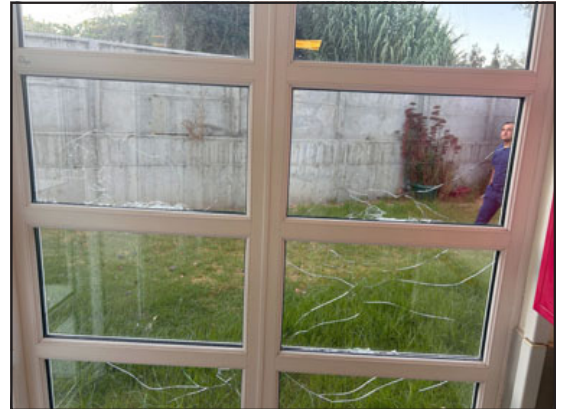
Destrozos en una de las puertas del recinto de salud.
