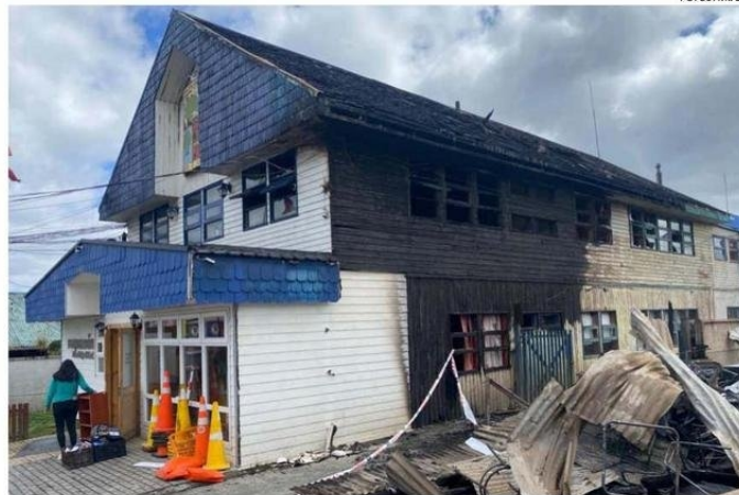
LA DESTRUCCIÓN DE LAS CONSTRUCCIONES EN CALLE JOSÉ MIGUEL CARRERA.
