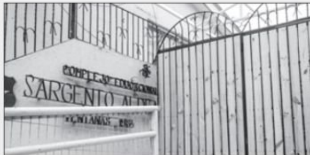
Así se ven actualmente las obras en el acceso principal del Complejo Educativo Sargento Aldea.
