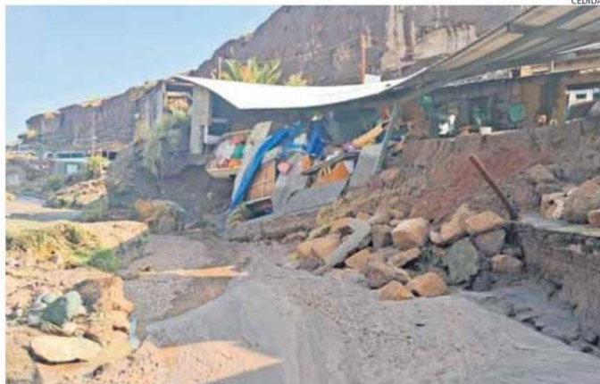
UNA DE LAS CASAS AFECTADAS POR LAS LLUVIAS Y EL DESBORDE DE LOS RÍOS EN EL PUEBLO DE CASPANA.
