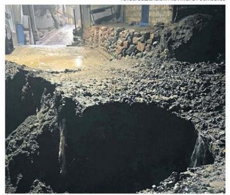
SOCAVÓN SE GENERÓ EN CAMINO DE QUEBRADA DE PARCA
