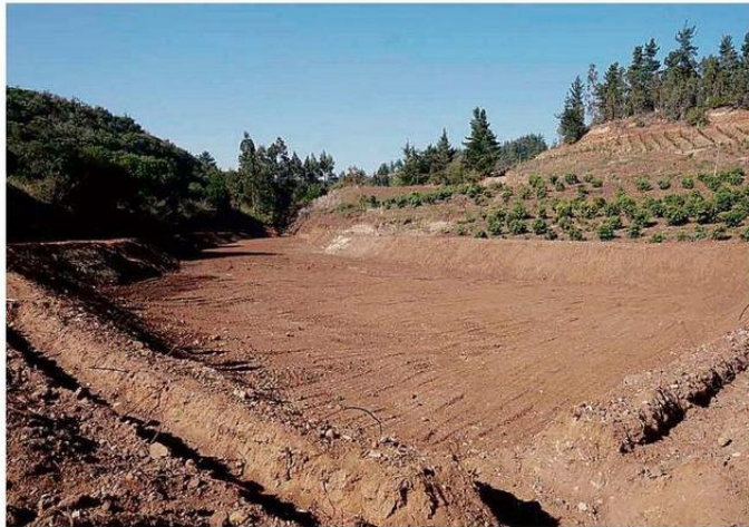
EL CONVENTO ESPERA AVANZAR CON SU PROYECTO DE AGUA POTABLE RURAL.
