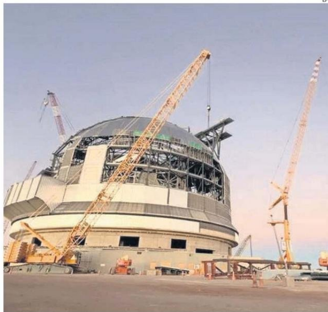
LA CÚPULA QUE ALBERGARÁ AL EXTREMELY LARGE TELESCOPE EN 2028 ESTÁ EN FASE DE CONSTRUCCIÓN.
